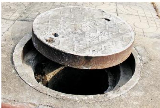
塔北路东与兴安大道交界处的窨井盖被撬开。陈慧 摄
