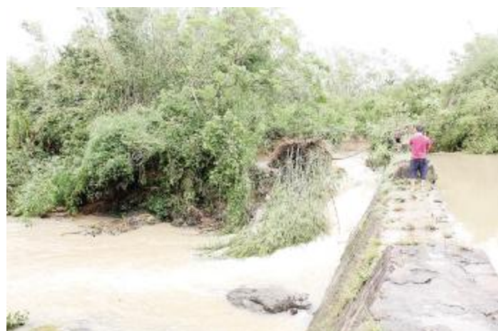
9月17日,定城镇美太村委会一处堤坝被水冲垮。叶松 摄
