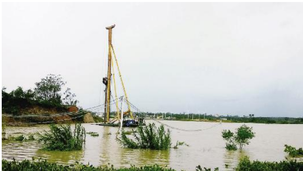
9月17日,定海大桥工地低洼处被淹,机器泡在水中。林先锋 摄
