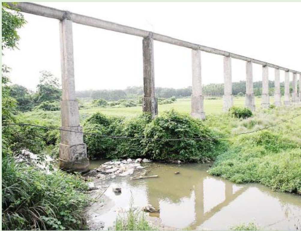
龙山镇抗坡桥垃圾浮在水面上。
